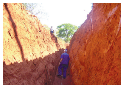
Obra foi feita com recursos próprios...
