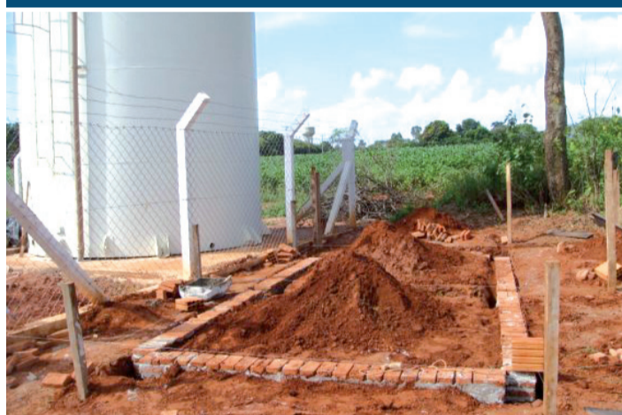
Construção da Casa de Química entre os bairros Vila Guarnieri e Nosso Teto
