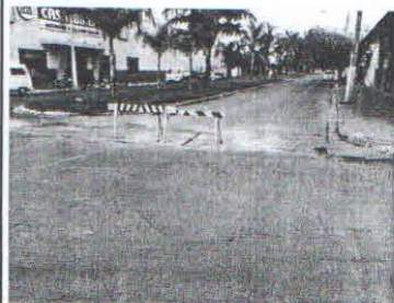
Canaleta no cruzamento da Av. Luiz Lemos de Toledo e Rua Marechal Deodoro que foi recuperada recentemente.
